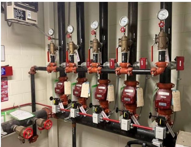
23 - FIRE SPRINKLER RISERS
